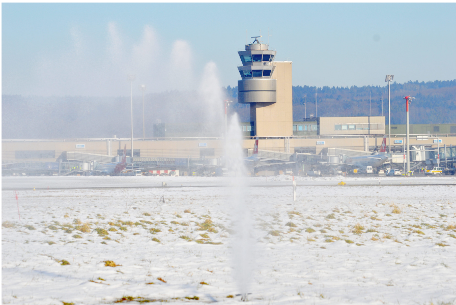
Die Sprinkleranlage versprüht die Enteiseraabwässer auf den Grünflächen.
