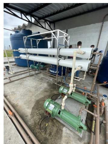
Die Anlage zur Umkehr-Osmose in Florianópolis
